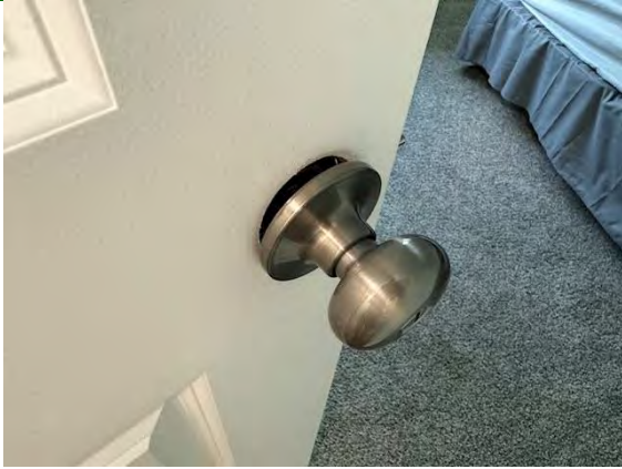
Unit # 7 Bedrooms & Living Space: LOOSE DOOR KNOBS
